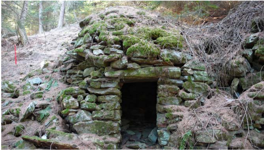
Ein crot, dessen äussere Mauerwerksschicht abgerutscht ist Foto: Christian Cortesi
