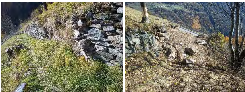
Fig. 17: Tipi di danno.
