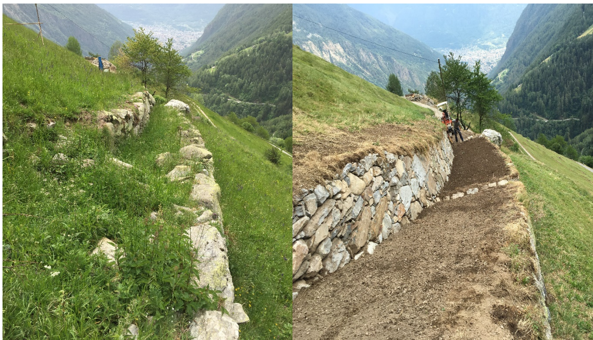
A sinistra sentiero tra i terrazzi completamente distrutto; a destra durante i lavori di ripristino.
